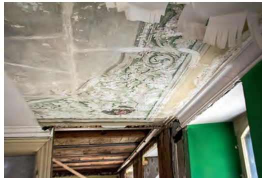
links: Verstärkungen der Holzträger, um die untenliegende beim Rückbau entdeckte Deckenmalerei zu schützen.
